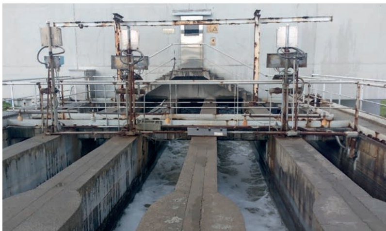
Figura 2. Zona de pretratamiento y zona de medición de la planta de tratamiento de agua residual.
